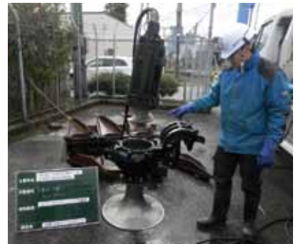
マンホールポンプの劣化診断(市実績)
