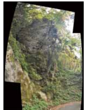
岩塊撤去設計現地状況(県実績)
